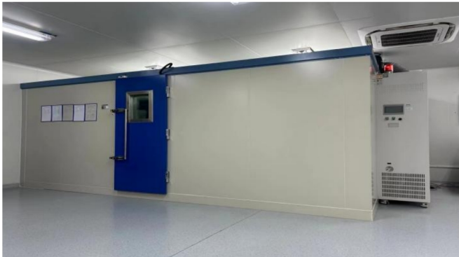
（压缩机户内放置）
